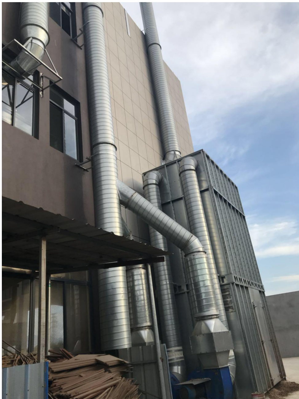
图 4-5 木工车间粉尘治理设施图
