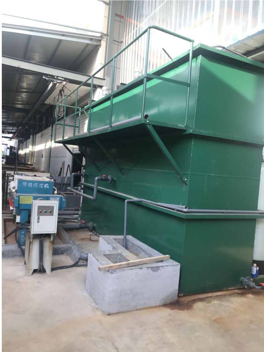
图 4-2 废水处理设施现场照片
