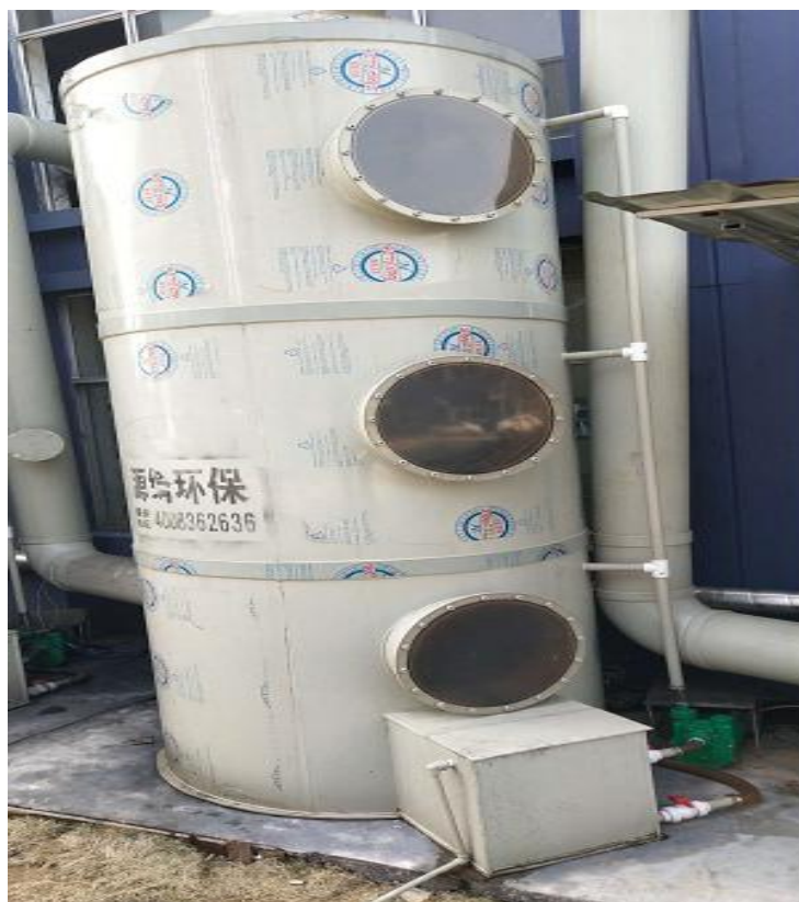
图 5-5 热风炉废气处理设施
